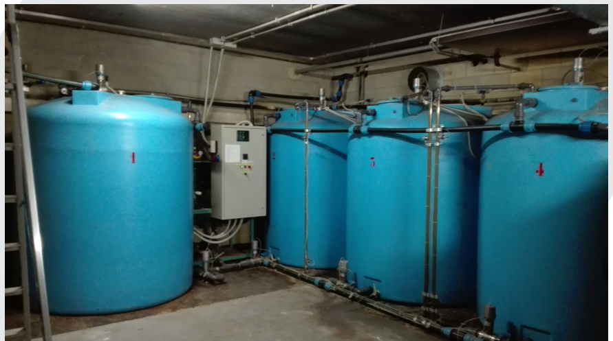
Esempio di WDMS NT-VK (vasche di decadimento e quadro con PLC)
